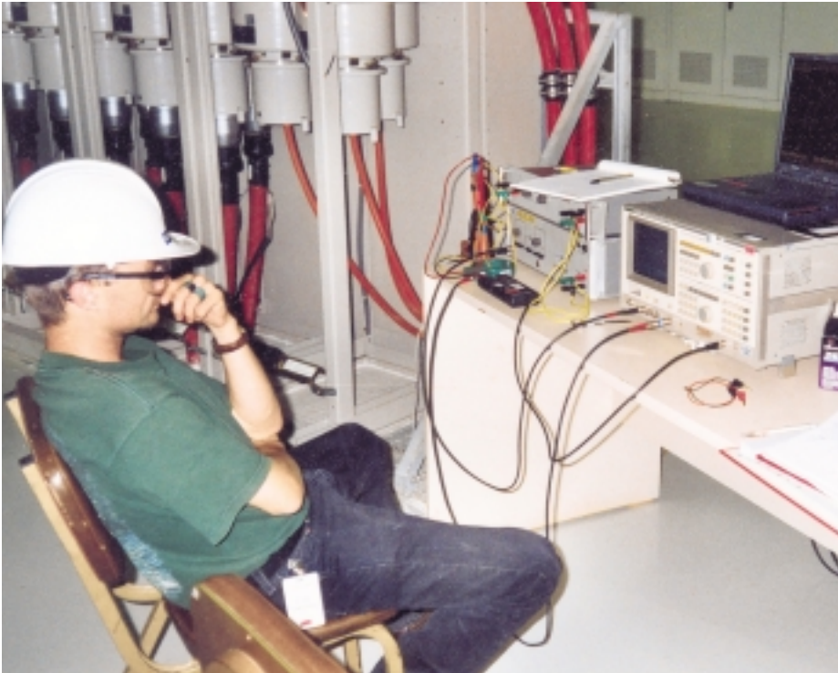
Messung mit Hochfrequenzrüstung in Hochspannungsumgebung; eine Herausforderung für die Ingenieure der montena emc sa
